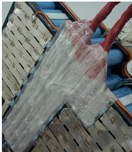
Ilustración 80: Borne cubierto por cinta aislante
