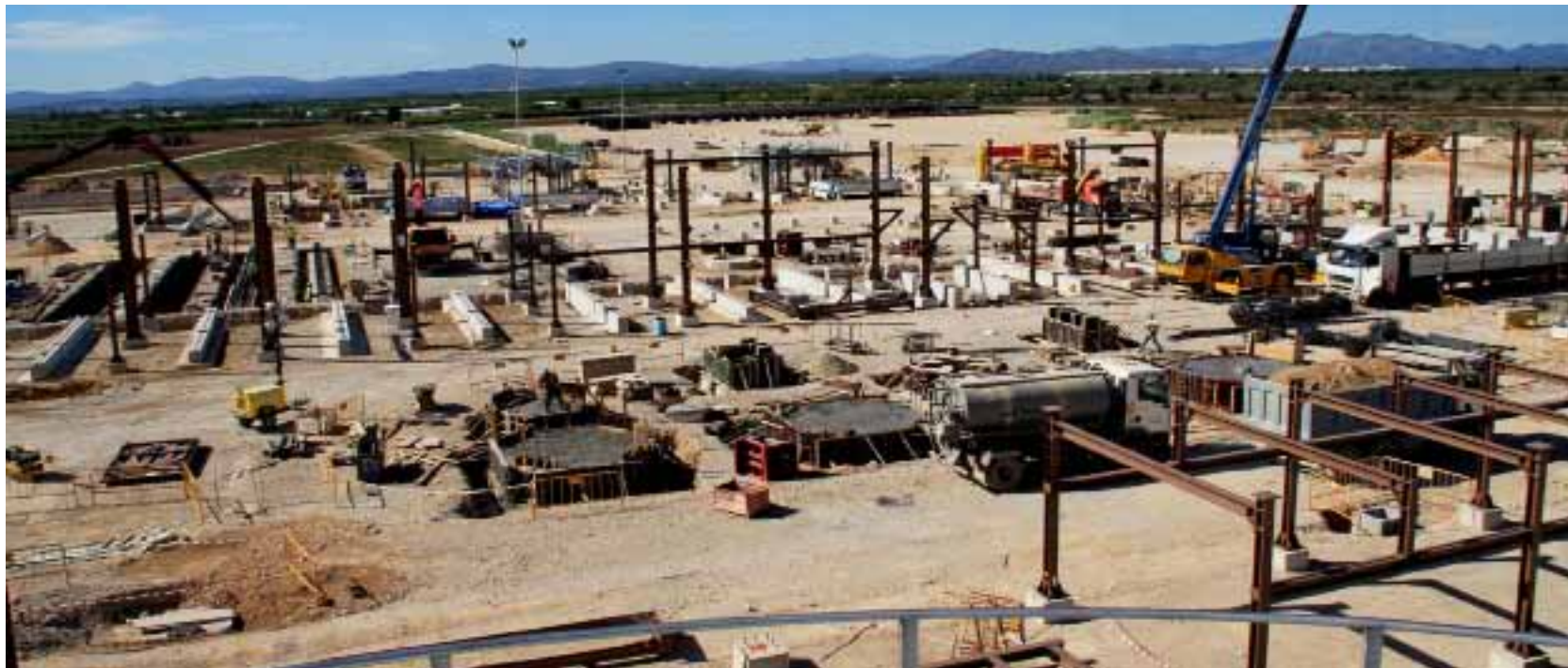
Vista de part de les obres de la plata d'operacions Ignacio Pérez
