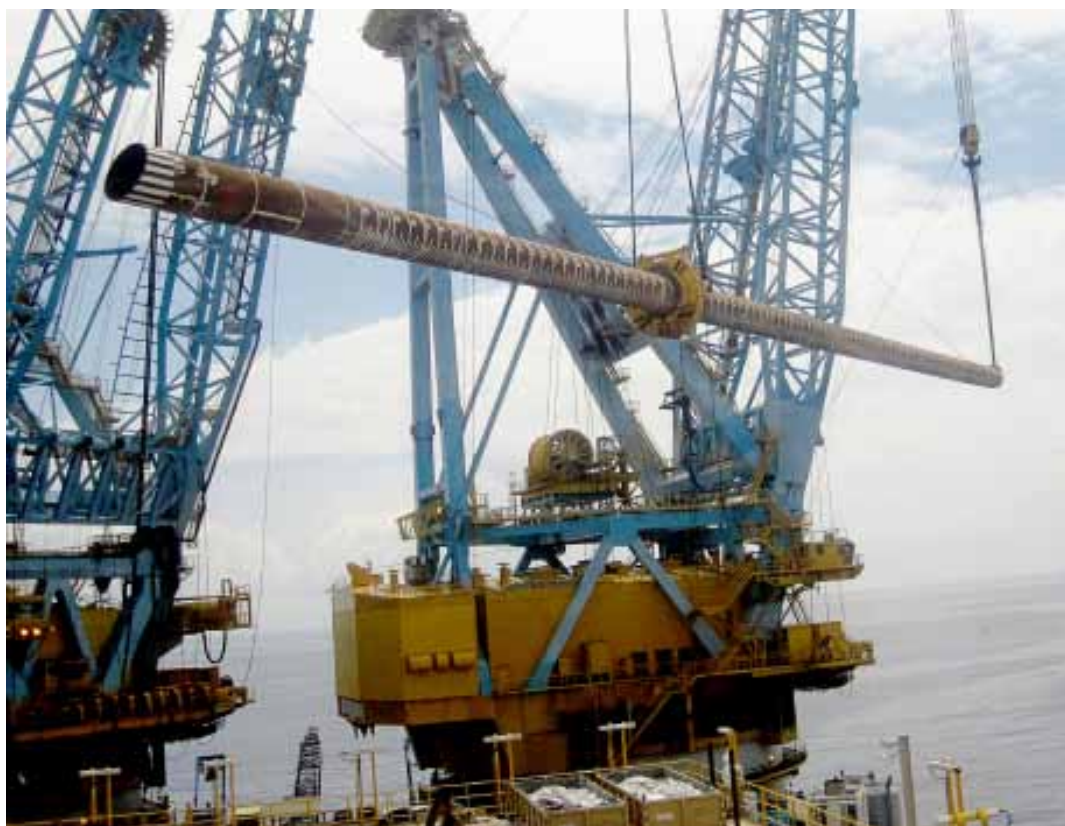
La grúa de la Saipem 7000 eleva uno de los 4 pilotes de 100 metros y 200 toneladas cada uno, que se deben anclar en el fondo marino.
