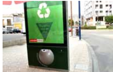
L'Ajuntament instal·la contenidors de recollida selectiva de piles
