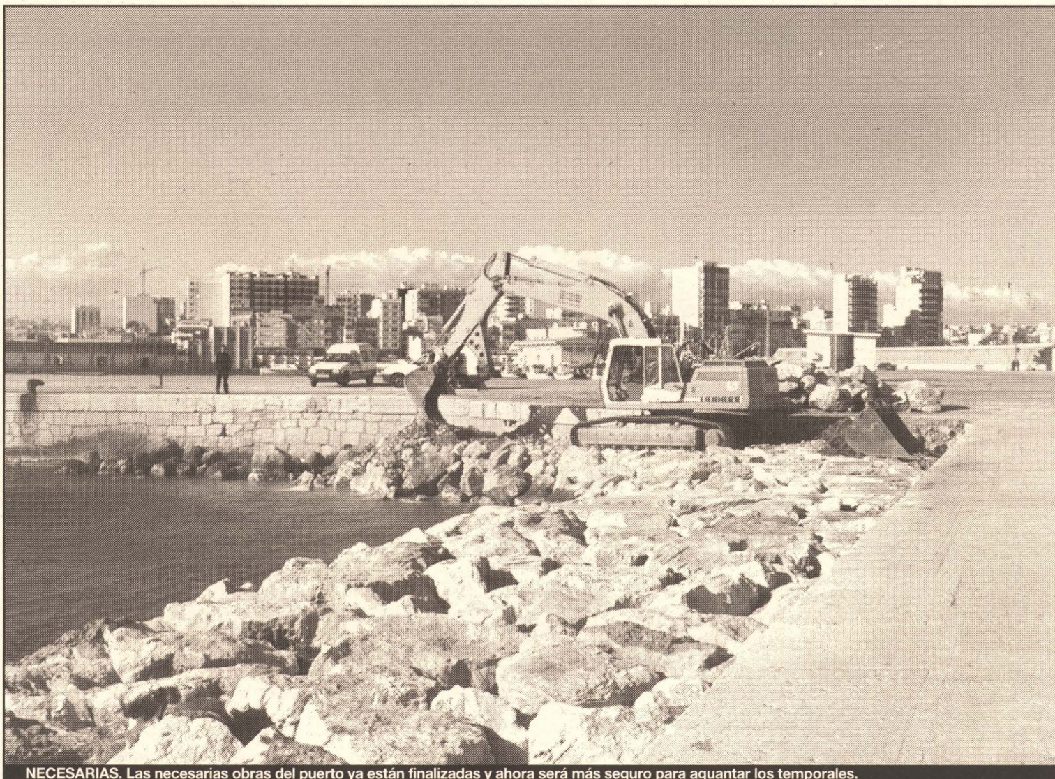
NECESARIAS. Las necesarias obras del puerto ya están finalizadas y ahora será más seguro para aguantar los temporales.
