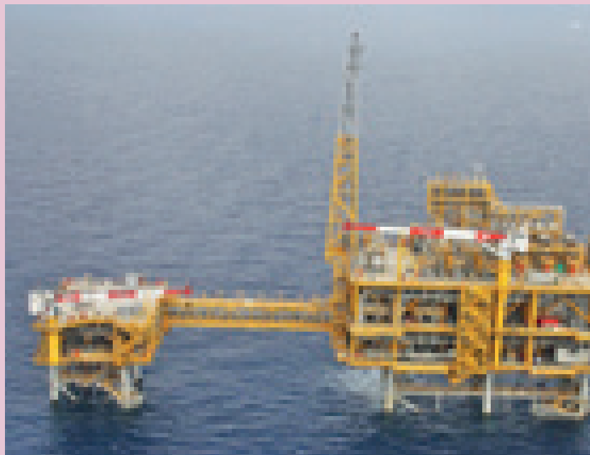
Planta marina del Proyecto Castor, a 22 km de la costa de Vinaròs
