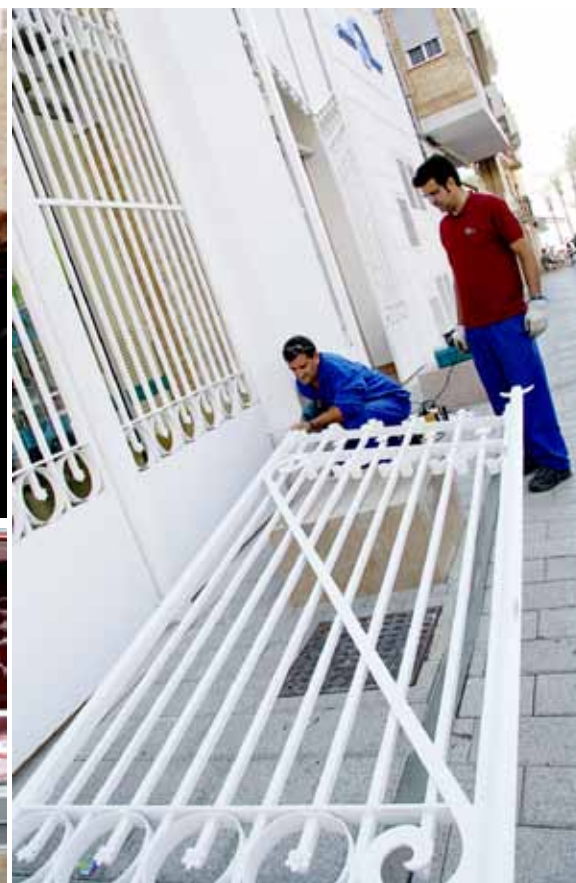
Una empresa de la ciudad reparó la puerta que cayó momentos después del incidente. Los accesos al recinto fueron todos revisados esta semana.
