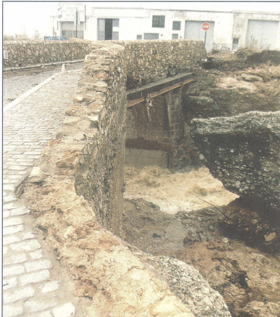
Destrozos en el puente romano
