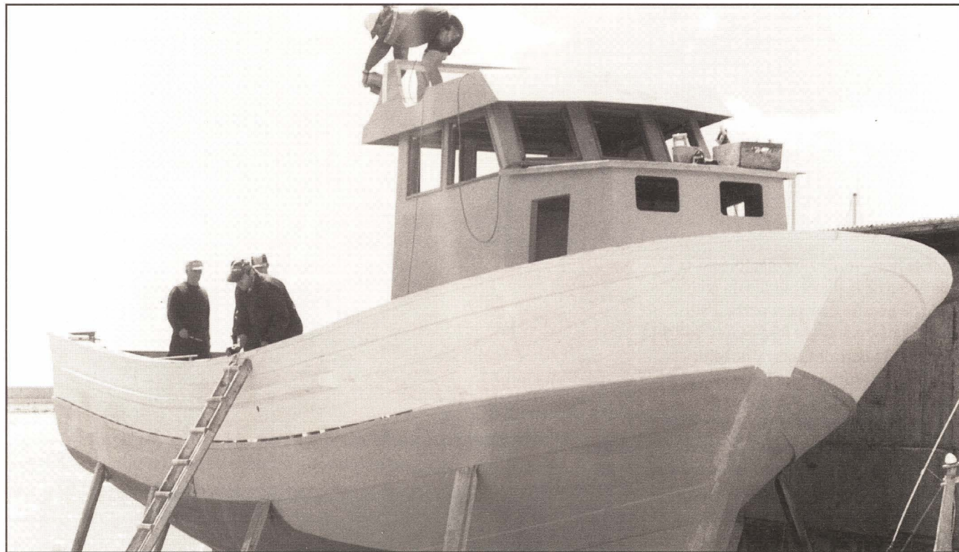
Última fase de la construcción del pesquero "CAIMÁN SEGUNDO" por los astilleros CASTELA, S.L. de Vinaròs. Foto: A. Alcázar
