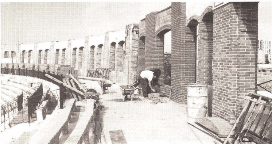
El anillo superior del tendido ha reforzado adecuadamente su estructura con materiales. Están reconstruyendo las arcadas por albañiles especialistas en colocación de ladrillos de obra vista. Las viguetas existentes antes son de madera. Foto: A. Alcázar
