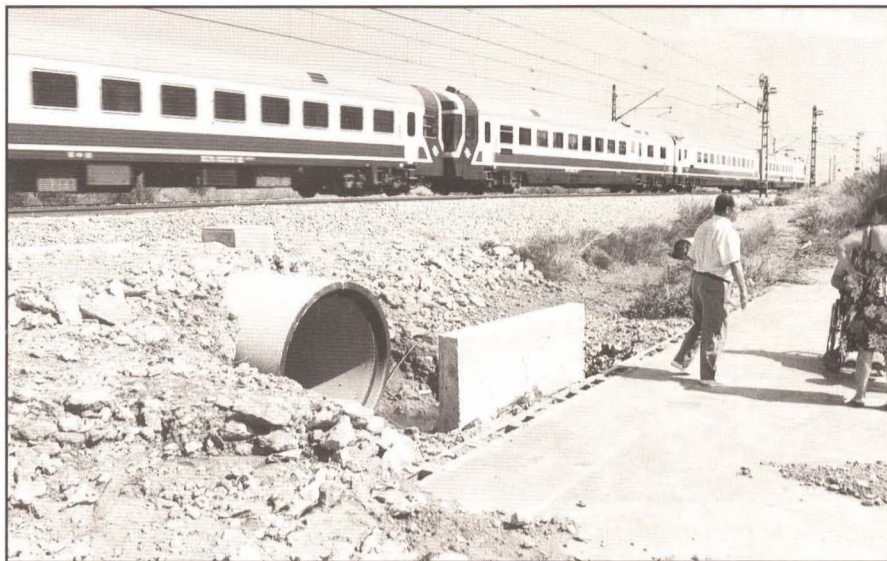
Este desagüe produjo las inundaciones del Hospital Comarcal y Colegio "Baix Maestrat". Foto: A. Alcázar
