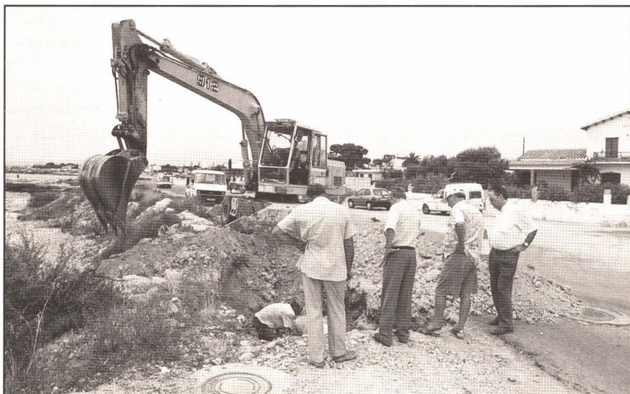
En la zona turística sur se han cumplido los plazos previstos y están finalizando las obra de agua potable y alcantarillado. Foto: A. Alcázar
