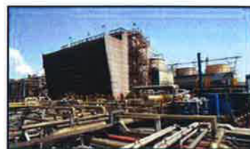
Figura 11: Torre de Refrigeración.
