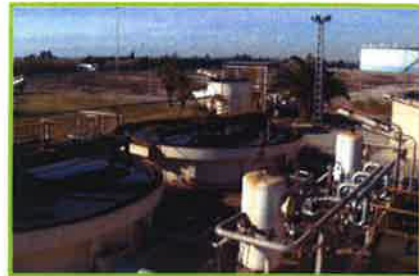
Figura 5: Planta de Tratamiento de Aguas Residuales, PTAR, de Refinería
