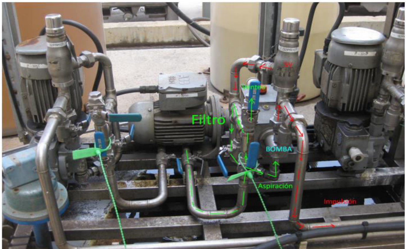
Ilustración 17.2.2. Detalle de la instalación de las P-3250 y P-3251
