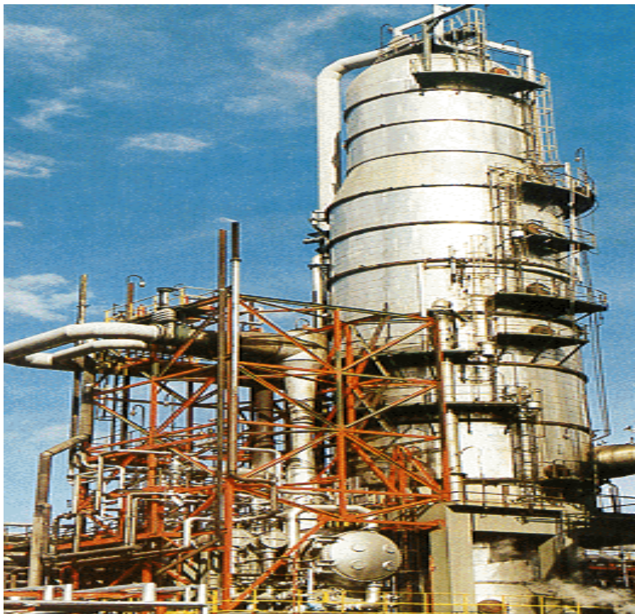
Ilustración 1.11. Imagen de la torre de vacío de la refinería
