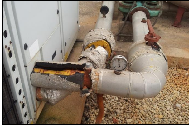
Figura 40: Estado tuberías en zona de cubierta
