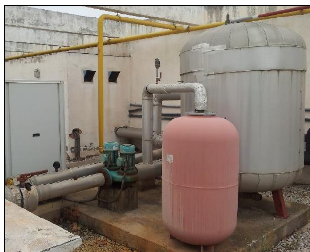
Figura 30: Bomba de calor CARRIER
