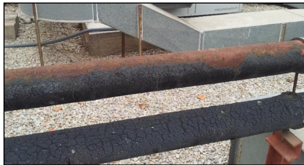
Figura 41: Estado tuberías en zona de cubierta
