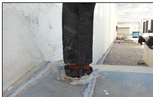
Figura 42: Estado tuberías en zona de cubierta
