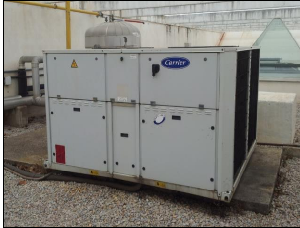
Figura 28: Bomba de calor CARRIER
