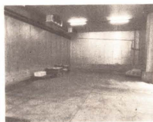
Cámara de refrigeración para pescados
