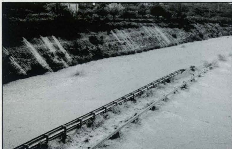
La carretera, completament coberta d'aigua
