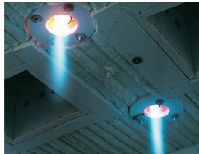
Calentamiento directo desde el techo con quemadores BIC (Kromschroeder)
