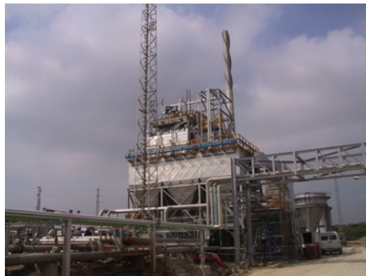
Filtro cerámico en caldera de residuos petroquímicos
