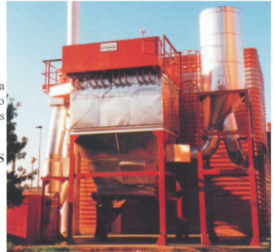
Sistema de filtración de emisiones en HORNO INCINERADOR DE RESIDUOS HOSPITALARIOS
