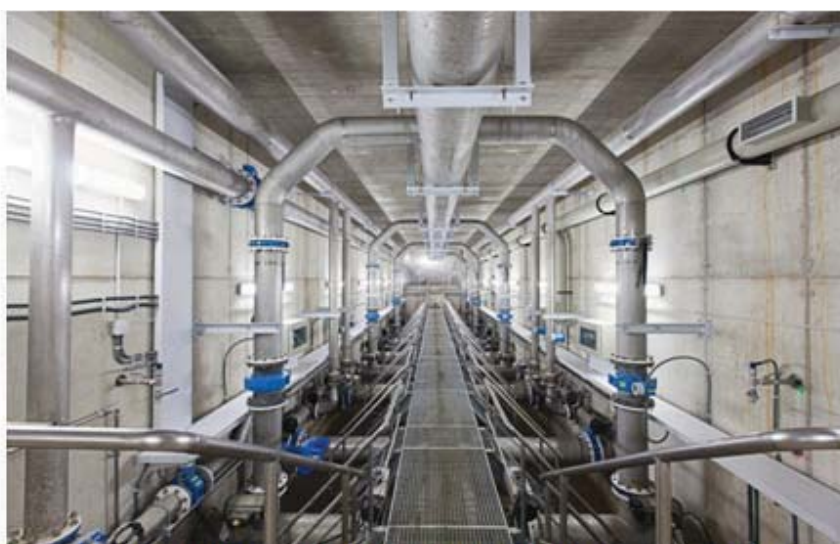
Zona de biofiltros, cámara de llaves y entrada y salida de agua
