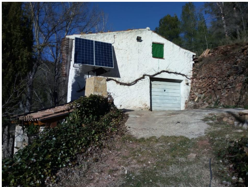
Ilustración 1. Paneles fotovoltaicos instalados en la fachada de la edificación
