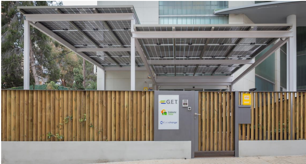
Ilustración 69. Pérgola fotovoltaica realizada por Cubierta solar
