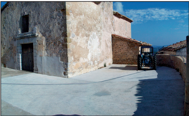
Figura 6. Delimitació de la superfície afectada durant l'excavació (observeu el canvi de tonalitat al paviment de formigó).
