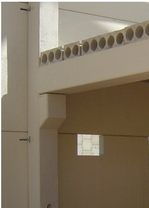
Figura 4.61: Mensulas de hormigon en pilar Unión pilar-viga, Ref. PAVI
