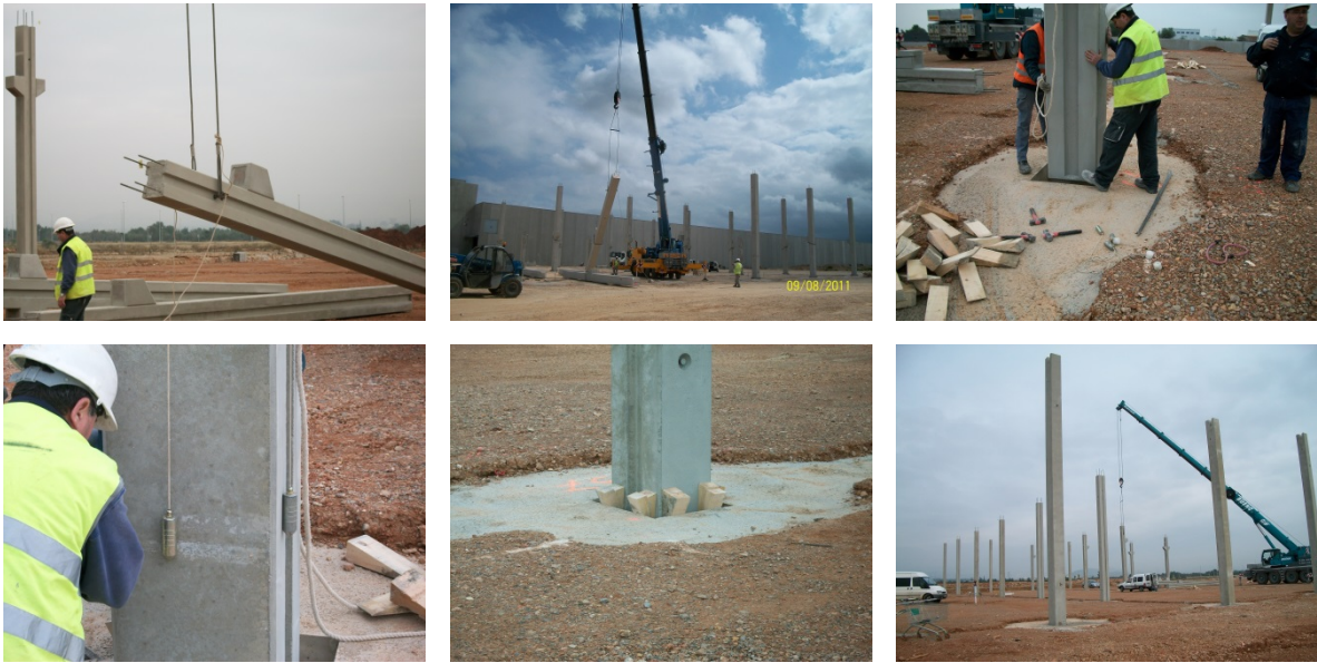
Figura 4.40: Elevación, manipulado y posicionamiento. Aplomado, acuñado y estado final del pilar. Ref. PAVI
