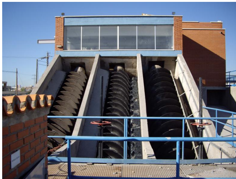
Figura 6: tornillo sin fin de salida de fangos de una EDAR
