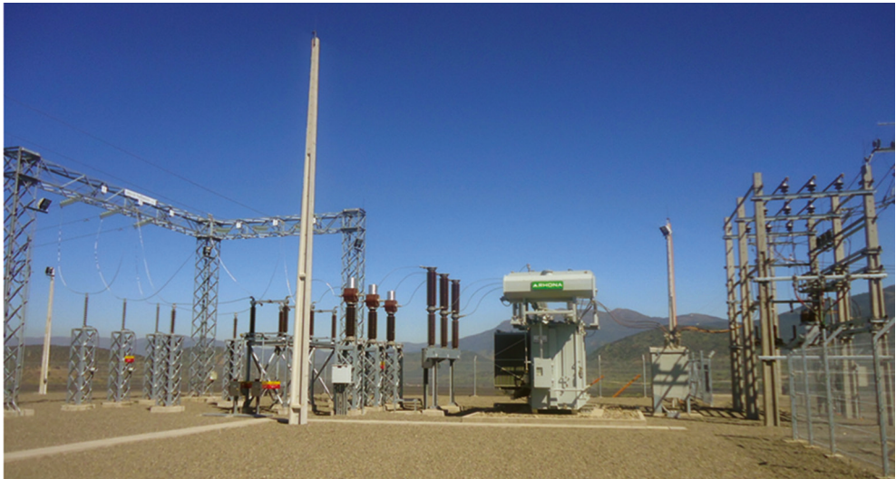
FIGURA 5.1.7. Subestación elevadora Loma Los Colorados.
