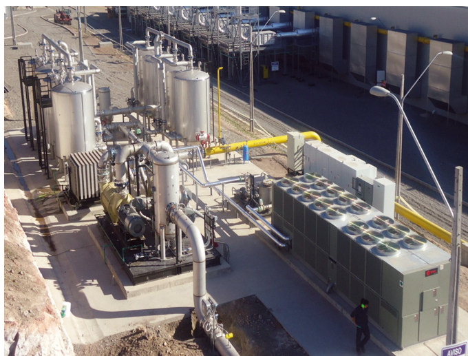
FIGURA 5.1.6. Planta de tratamiento de biogás.
