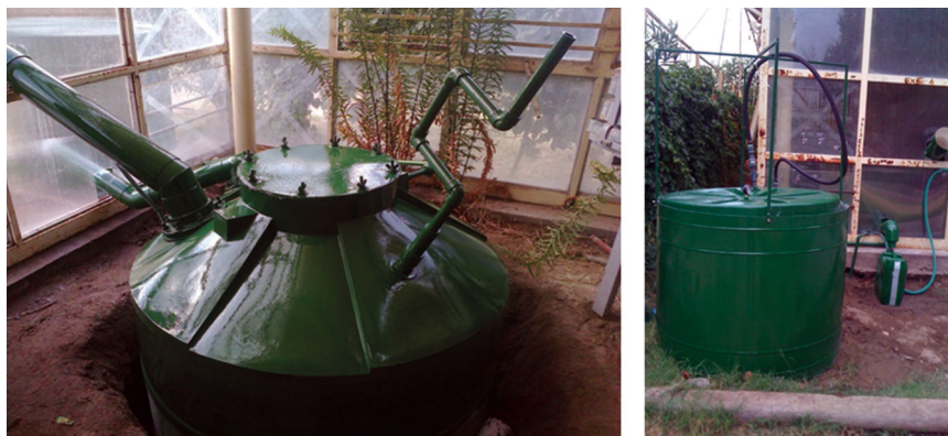
FIGURA 4.3.4. Biodigester construido en escuela Moses J. Chade. Acumulador de gas, cámara de carga y descarga de biodigester.
