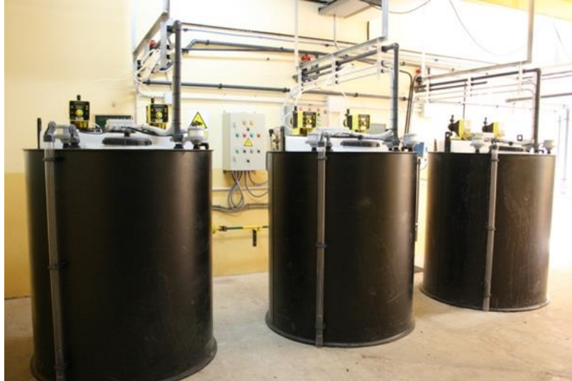
Imagen 21. Imagen exterior de los depósitos de dosificación química. Fuente: página de Talleres Transglass. ( http://www.transglass.net/servicios2/trabajos-realizados/110-hipoclorito-etap )
