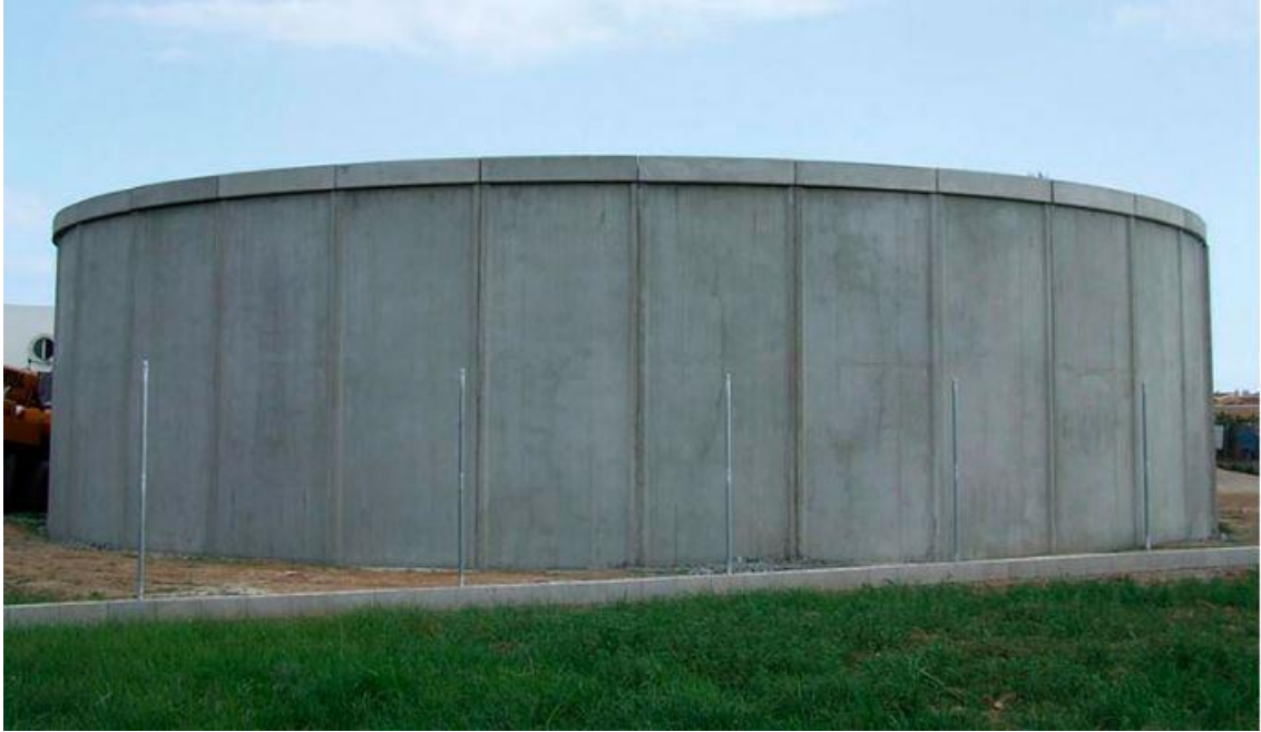
Figura 28. Imagen exterior del depósito de almacenamiento de agua tratada. Fuente: Ciaqua. ( http://ciaqua.es/depositos/ )
