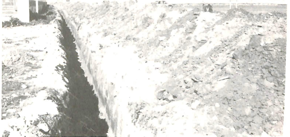
Han començat les obres per a desviar la claveguera al sud del Morrongo
