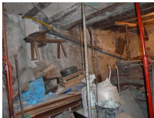
FOTOGRAFÍAS 05 Estructura apuntalada por la humedad
