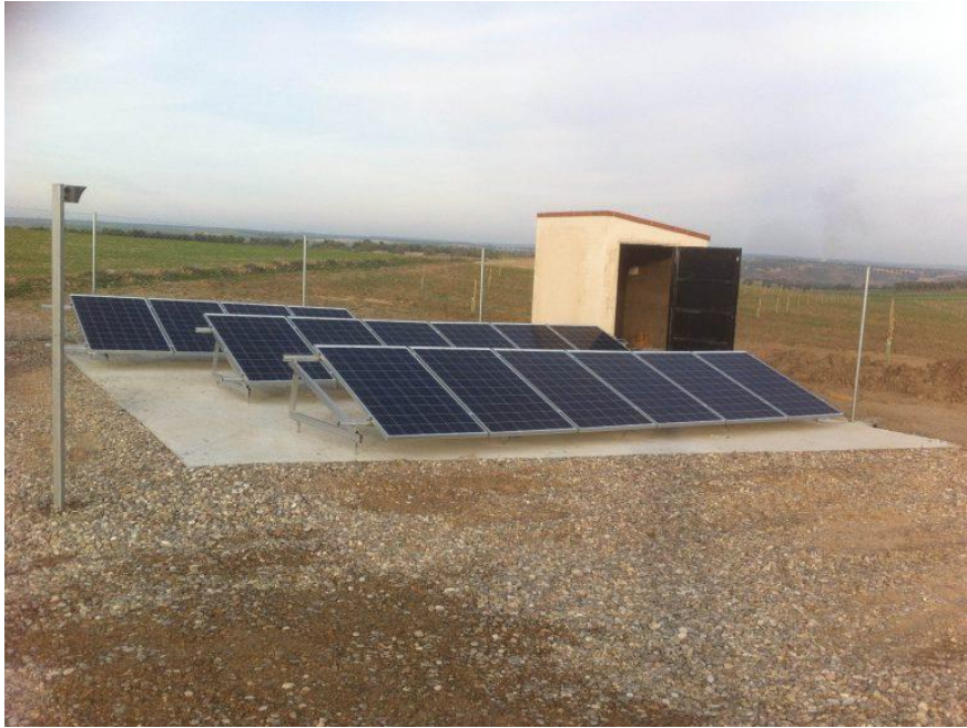
Ilustración 12 Instalación solar para bombeo.
