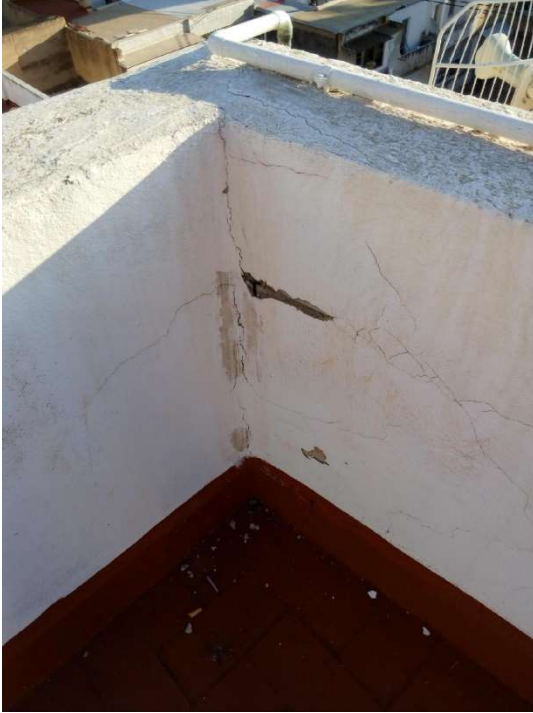
Figura 36. Fisura antepecho cubierta, (Fuente: autor)
