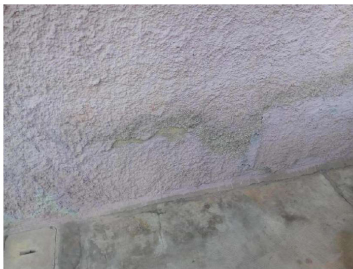
Figura 34. Desconchados pintura, humedades por capilaridad, (Fuente: autor)
