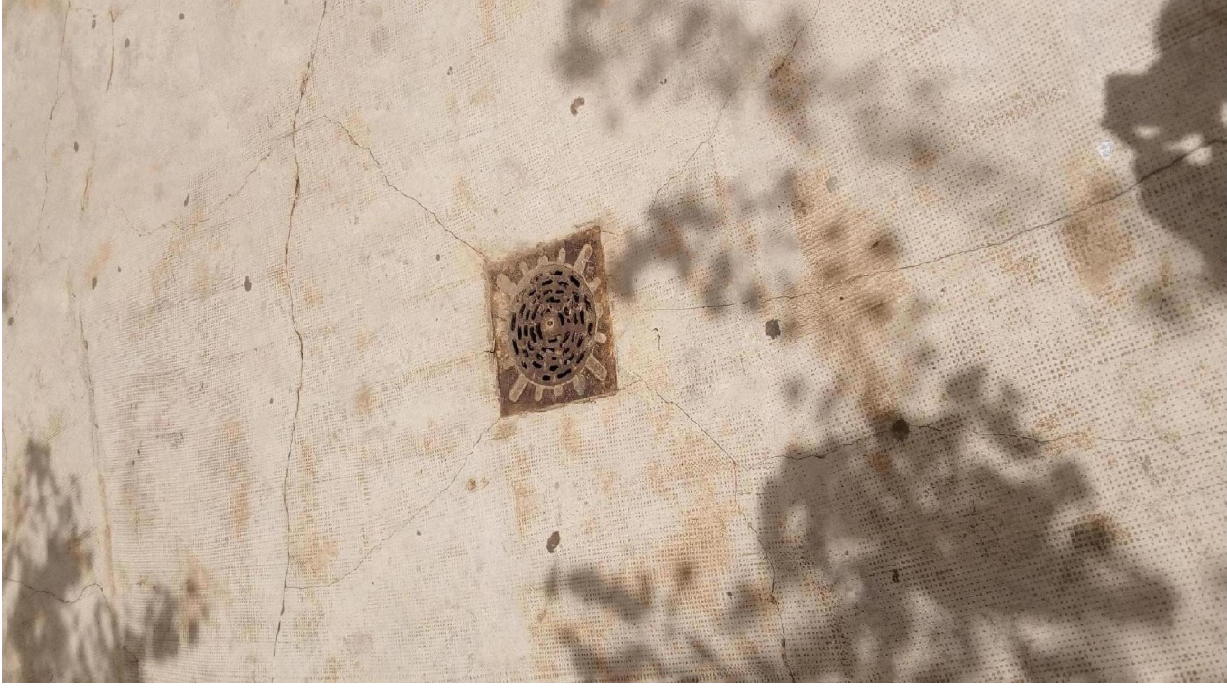
Evacuación de aguas. Arquetas. [Ref. IN004]
