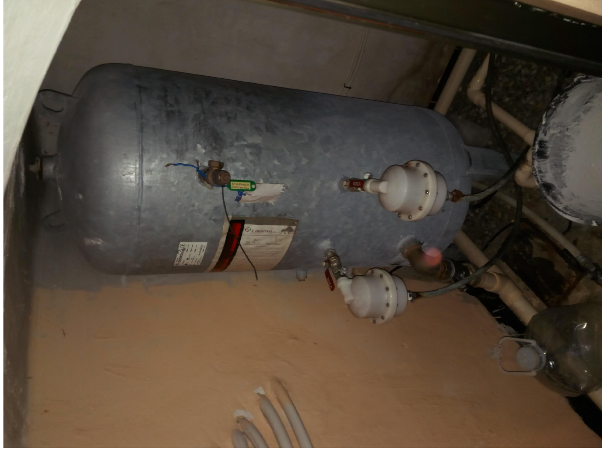
Suministro de aguas. Otros. [Ref. IN002]
