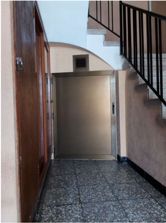
Figura 26. Situación cuarto contadores, (Fuente: autor).
