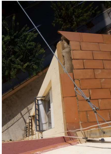
Figura 38. Falta de piezas cerámicas en cubierta, (Fuente: autor)
