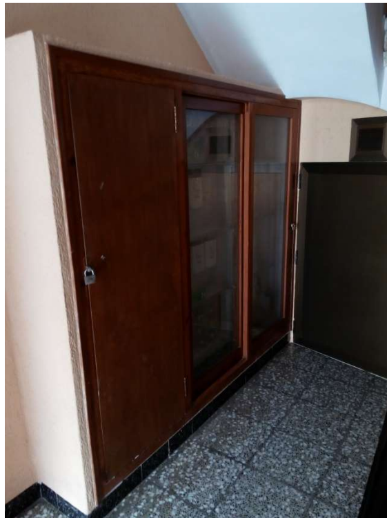
Figura 29. Armario contadores, (Fuente: autor).
