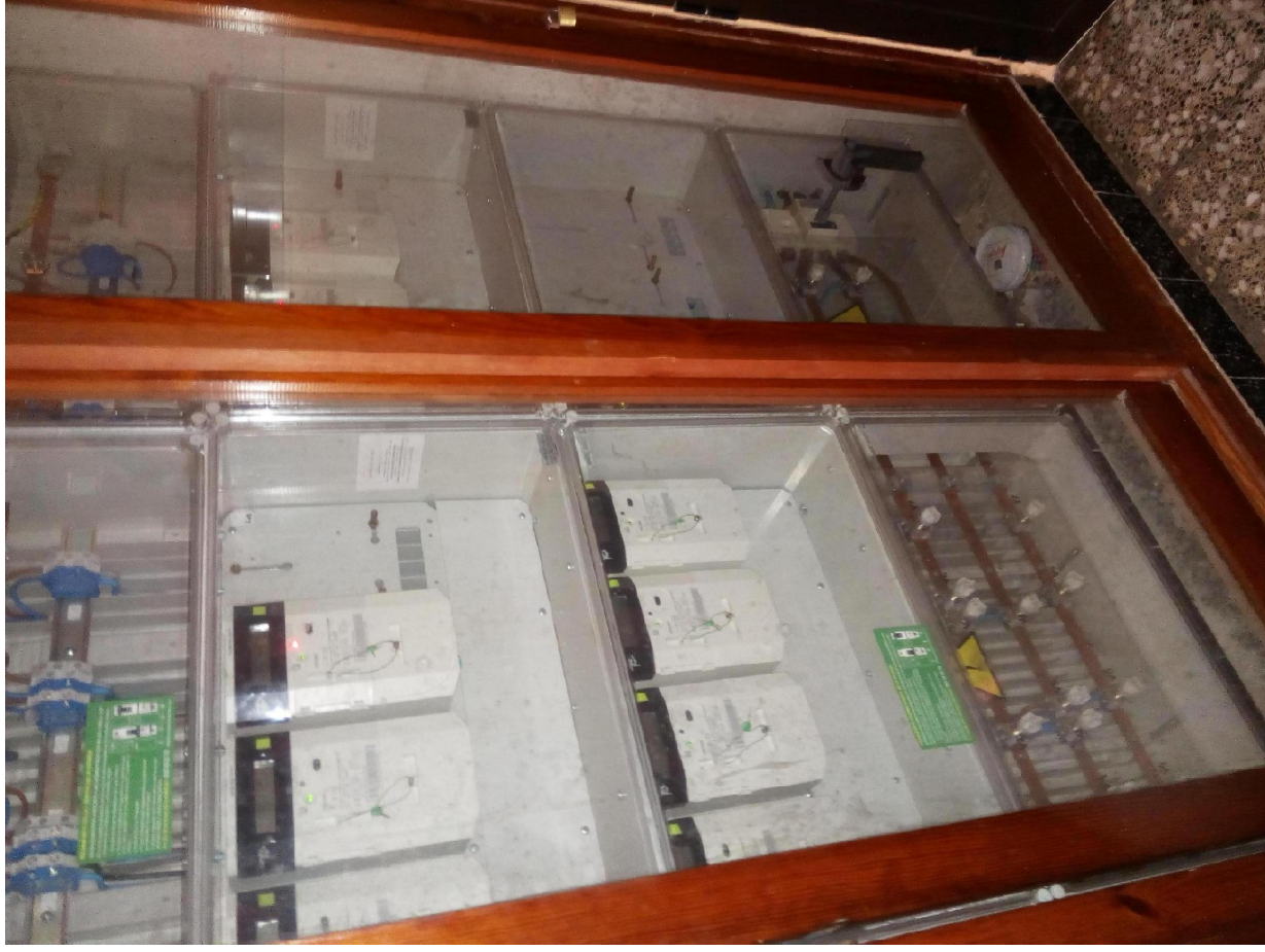
Suministro eléctrico. Cuadro de contadores. [Ref. IN005]
