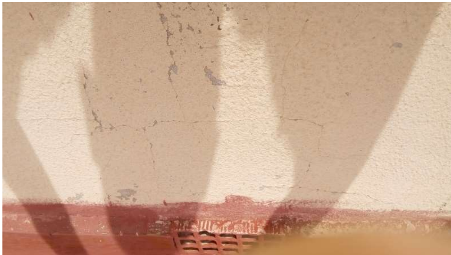
Figura 19. Ventilación en fachada, (Fuente: autor).
