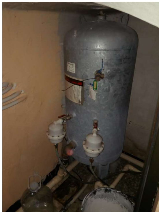
Figura 28. Calderín, (Fuente: autor).
