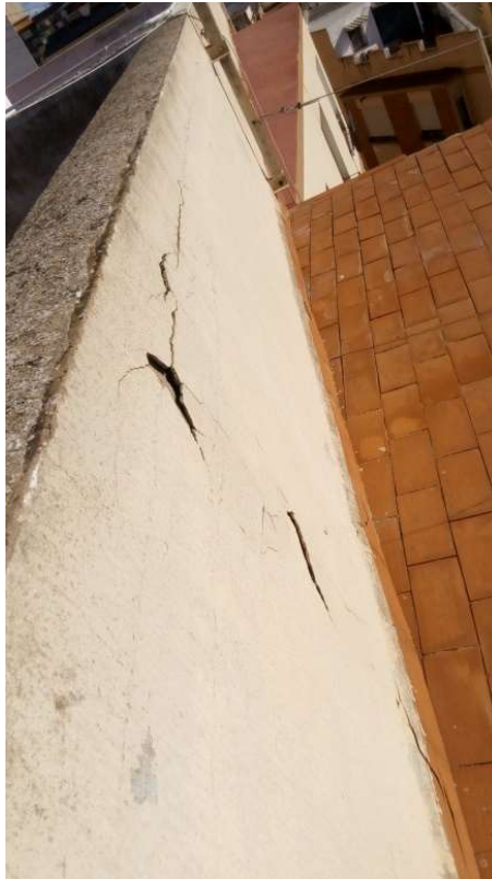
Figura 35. Desprendimiento del enlucido de mortero en antepecho, (Fuente: autor)
