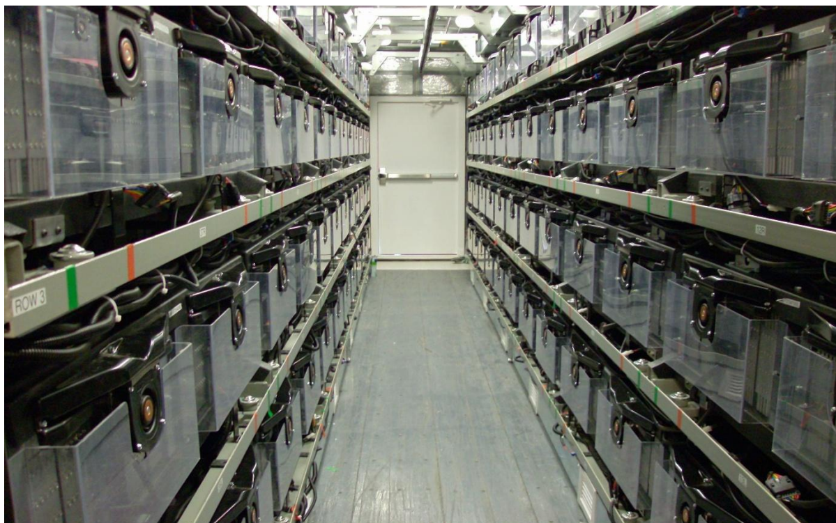
Figura 22. Interior del container de baterías de ion-litio.
