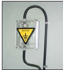
Figura 1.7: Caja de Seccionamiento de Servicio de Neutro
