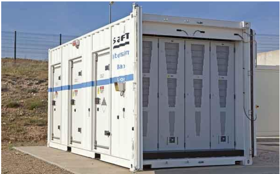
Figura 21. Sistema modular de baterías de ion-litio de 560 kWh.
