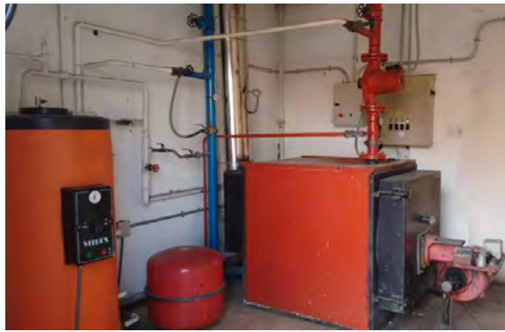
Imagen 16 .Interior sala de calderas.
