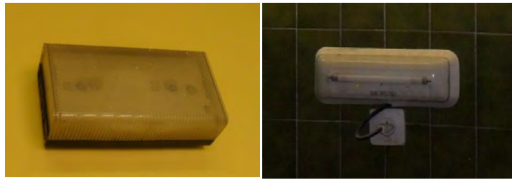
Imagen 13. Luces de emergencia
