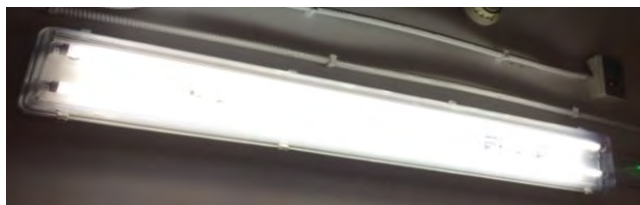
Imagen 11. Luminaria de pantalla con dos tubos T8
