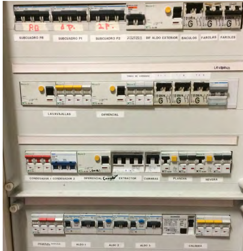
Imagen 7. Cuadro General Baja tensión
