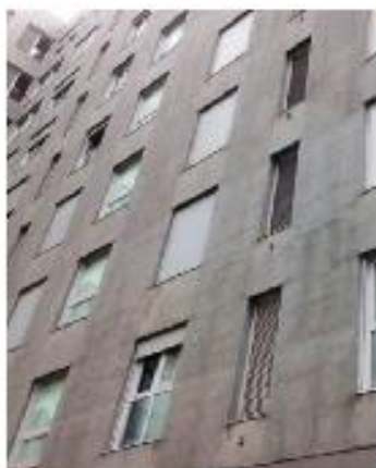
Destonificaciones de la capa de acabado
