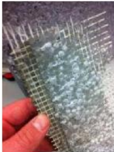
Trasdos de la capa base que ha adherido a la "costra" de EPS
