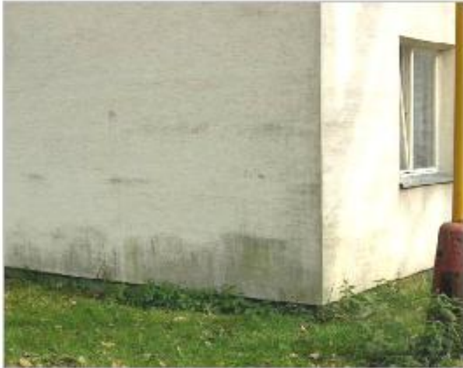
Humedad de remonte.
