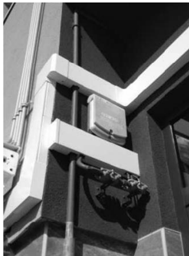
Figura 3-18. Instalación en superficie. Fuente: M. Epelde (2015)
