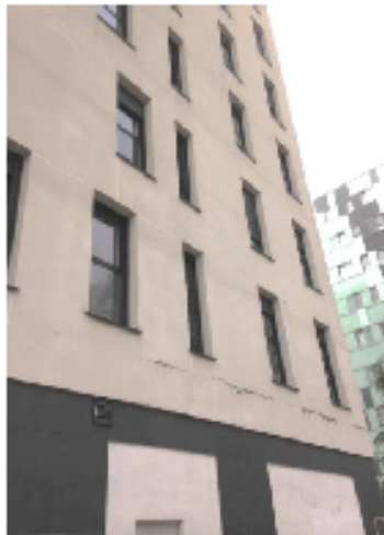
Destonificaciones de la capa de acabado
