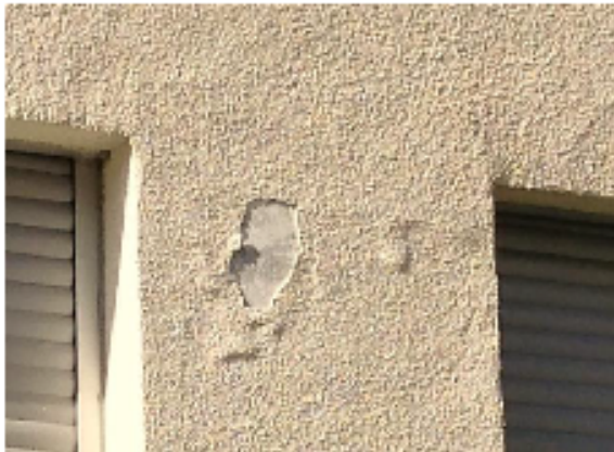
Desprendimiento del revoco de acabado
