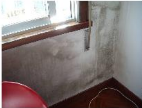
Humedad de condensación superficial en el interior después de la ejecución de un SATE.
