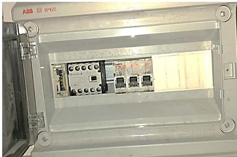
Fig. 26 (Font pròpia): Quadre de control de la il·luminació de la zona d'accés públic de les parades de venda (passadissos i zones d'accés del Mercat). Es compona d'un interruptor horari analògic connectat a un contactor i tres magnetotèrmics.
