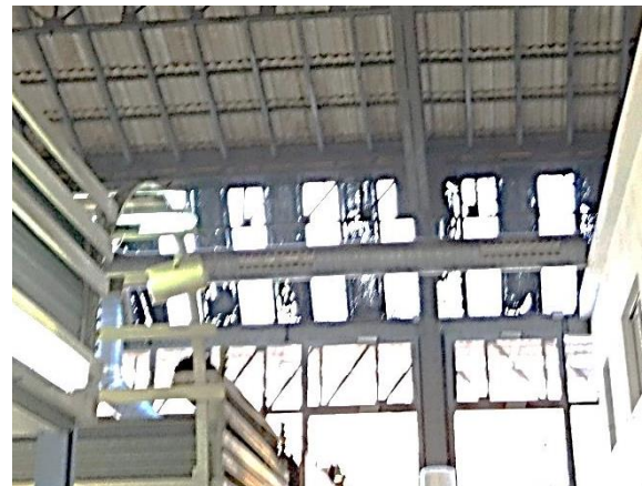
Fig. 11 (Font pròpia): En l'actualitat les finestres estan pintades amb pintura negra de forma alterna. Aquesta pintura està en mal estat de conservació.
