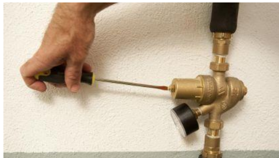
Fig. 174 ( www.hogarmania.com ): Procediment per a regular la pressió de la xarxa interior. El reductor de cabal disposa d'un manòmetre per a consultar la pressió interior obtinguda.
