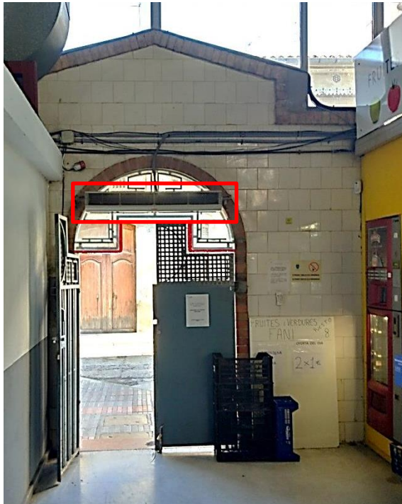
Fig. 33 (Font pròpia): Fotografia de la cortina d'aire ubicada a la porta P3 del Carrer Cristòfol Colom, a la única porta que no compta amb automatització. L'altura de les cortines d'aire es de 2'20 m aproximadament.
