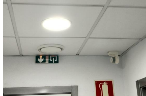
Fig. 27 (Font pròpia): Detector de moviment i lluminària al distribuïdor d'entrada als banys.
