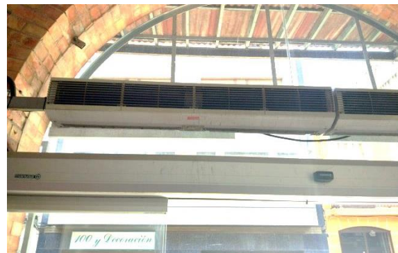
Fig. 15 (Font pròpia): Cortina d'aire ubicada sobre la porta automàtica.
