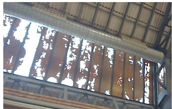
Fig. 12 (Font pròpia): Estat actual de les finestres de la cara Sud-Oest. El poliuretà de la coberta en descomposició cau sobre les finestres.
