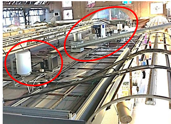
Fig. 18 (Font pròpia): La falta de centralització de serveis com ACS provoca que hi haja nombrosos escalfadors elèctrics. També hi ha nombrosos (sobre 20) sistemes de climatització individuals per a les parades de venda.
