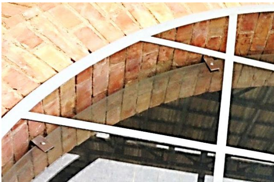
Fig. 14 (Font pròpia): Es pot observar l'espai que hi ha entre el mur i el vidre de la part superior de la porta d'accés del carrer Cristòfol Colom.
