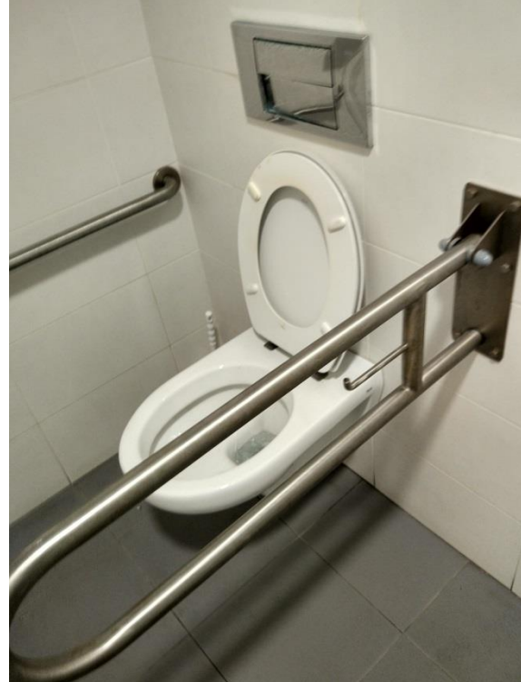
Fig. 53 (Font pròpia): WC del bany de dones, que perd aigua. La descàrrega es mitjançant fluxòmetre, una descàrrega amb pressió de xarxa sense acumulació (cisterna).
