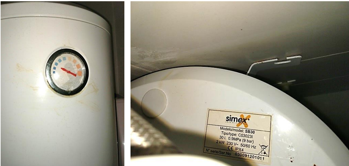
Fig. 45 i 46 (Font pròpia): Fotografies de l'escalfador d'ACS per a consum del Mercat. Esta ubicat a la sala destinada a neteja ubicada a la planta baixa. Te una capacitat de 30 litres i una potència de 2 kW. Es destina principalment a producció d'aigua calenta per a l'aixeta d'aquesta sala.
