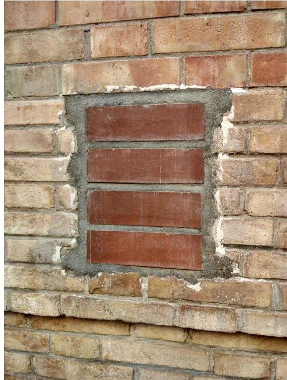
Fig. 57 (Font pròpia): Rajoles de la façana principal que han estat substituïdes per rajoles modernes, d'una forma molt poc integradora amb l'aspecte històric de la mateixa.
