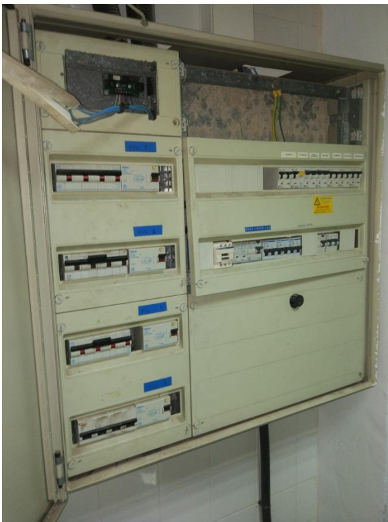
Fig. 49 (Font pròpia): Quadre elèctric de climatització, portes automàtiques, cortines d'aire i altres circuits comuns del Mercat.
