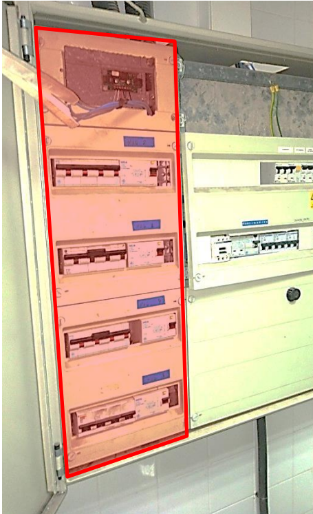
Fig. 40 (Font pròpia): Fotografia del quadre elèctric de comandament, la part concreta de les màquines climatitzadores esta marcada amb roig. Es poden veure 4 grups, un per màquina, de magneto tèrmic 3F+N (trifàsic) i diferència. En la part superior hi ha el lloc on es trobava el terminal d'usuari (regulador programable).
