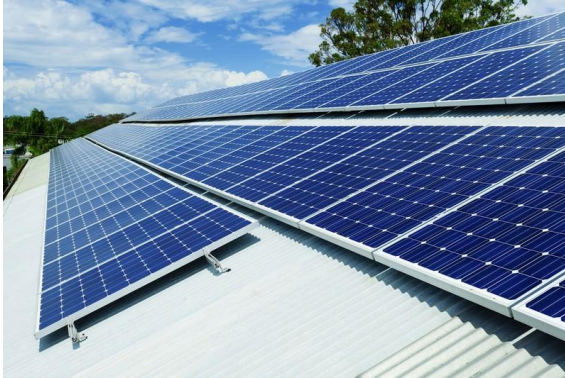
Fig. 91 ( www.gpstecnicasmetalicas.com ): Coberta inclinada amb panells solars col·locats pel seu costat vertical.
