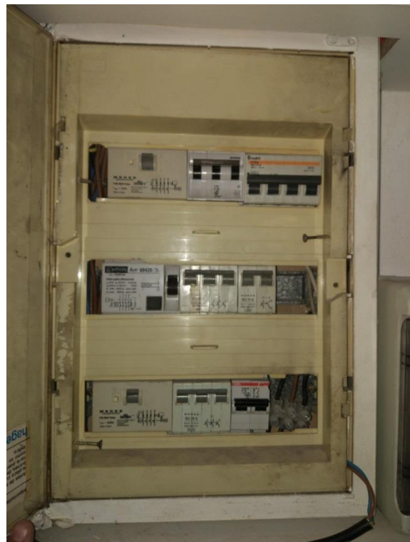
Fig. 50 (Font pròpia): Quadre elèctric ubicat junt a la sala de comptadors.
