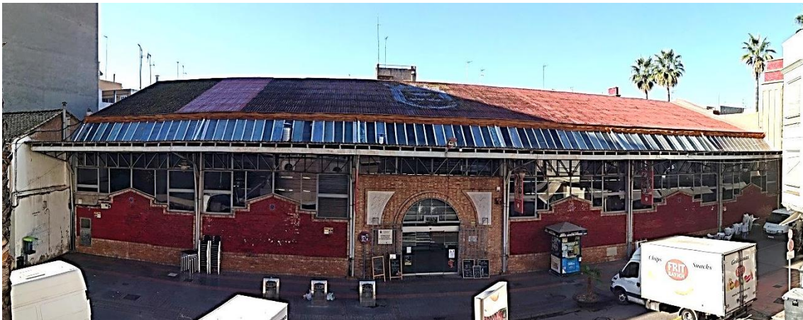
Fig. 16 (Font pròpia): Fotografia de la part nord del Mercat, on es pot apreciar la capa de poliuretà en color ataronjat i la capa de pintura en color rogenc. També s'observa a la part esquerra de la coberta algunes reparacions sobre aquesta.
