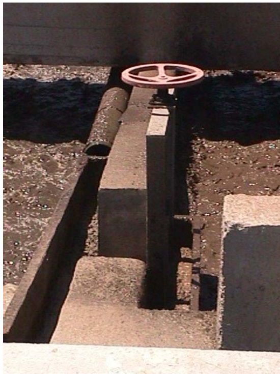
COMPUERTA REACTOR DIGESTOR
