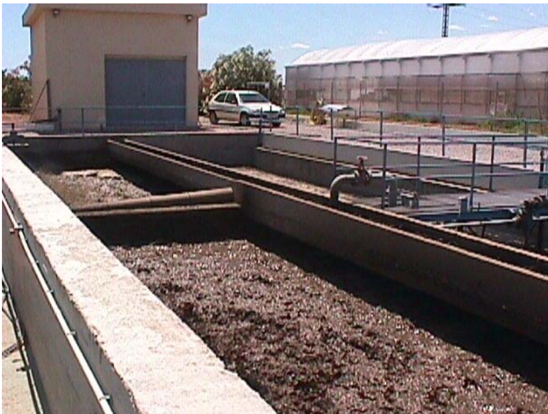
DECANTADOR RECIRCULANDO A REACTOR
