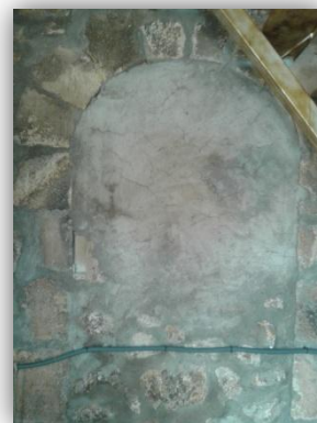
En esta imagen se observa uno de los dos huecos de la zona de campanas que han sido tapados.
