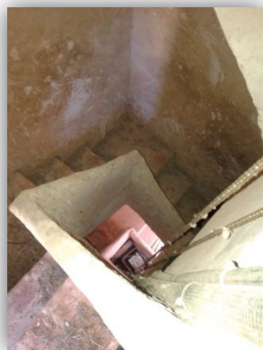
En esta imagen se observa la zona de escaleras hasta llegar a la zona del reloj.
