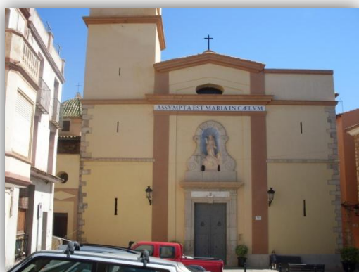
En esta imagen se observa como el basamento de una de las caras de la torre forma parte de la fachada principal de la iglesia.
