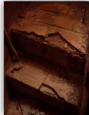
En esta imagen se observa el mal estado de los peldaños de acceso a la zona de campanas.
