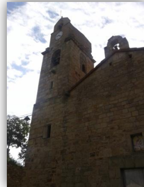
En esta imagen se observan las caras noreste y sureste. Se puede observar la ventana existente para acceder al tejado de la iglesia.
