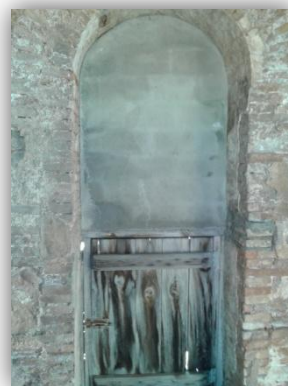
En esta imagen se observa el perímetro de los huecos realizado con ladrillos de barro, el hueco tapiado y la ventana que da acceso a la cubierta de la iglesia.
