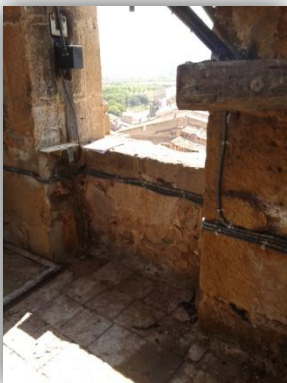
En esta imagen se observa el peto de uno de los huecos de la zona de campanas. Tambien se puede observar como el solado de dicho cuerpo es de baldosas de barro.
