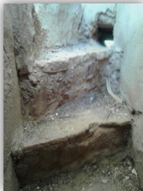
En la imagen se observa el mal estado de los peldaños en los últimos tramos.
