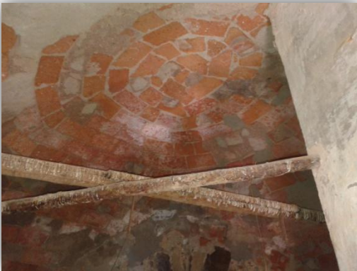
En esta imagen se observa la boveda de pechinas que sujeta el suelo del cuerpo de campanas.
