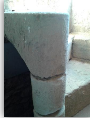
En esta imagen se observa cómo se apilan las piedras para formar los escalones.
