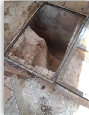
En esta imagen se observa la llegada de la escalera al cuerpo de campanas. Se ha colocado una reja metalica para evitar la entrada de palomas.
