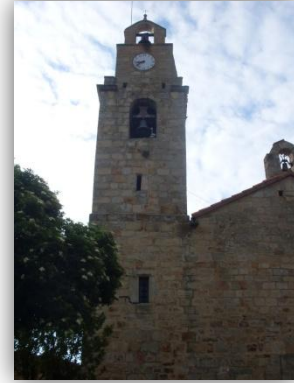
En esta imagen se observa la cara noreste de la torre. Se pueden diferenciar todos los niveles, el paramento, la zona de campanas, la zona de reloj y la cubierta con el campanil.
