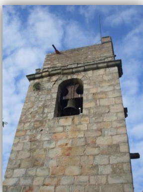
En esta imagen se puede ver el hueco de la cara sur este con su campana. Tambien se observa como proliferan las plantas en el muro.
