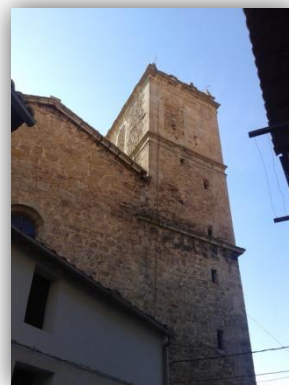
En esta imagen se observan las caras oeste y norte de la torre, se pueden observar los huecos para iluminar las escaleras. También se observa como han sido tapiados los huecos de la zona de campanas.
