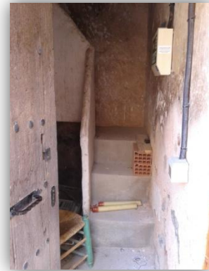
En esta imagen se observa los primeros escalones, se puede ver que han sido reparados.
