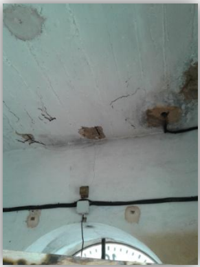
En esta imagen observamos desconchados en el techo de la zona del reloj.
