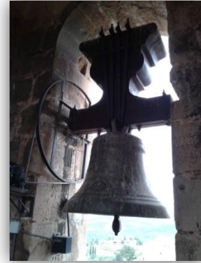
En esta imagen se observa uno de los huecos de la zona de campanas con su respectiva campana.
