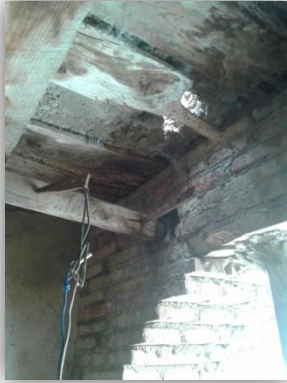
En esta imagen se observa el forjado de la cubierta, se puede observar que ha sido reparada con una capa de hormigón.
