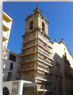
En esta imagen se observa el andamio para la restauración del campanario.
