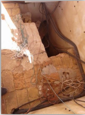
En la imagen se observa el acceso a la zona de campanas, así como el solado que existe.
