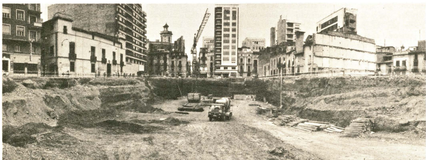
Las obras del aparcamiento subterráneo en la plaza de enlace de la calle de Colón con la Avda. de Cernuda y Velasco, van a buen ritmo.
