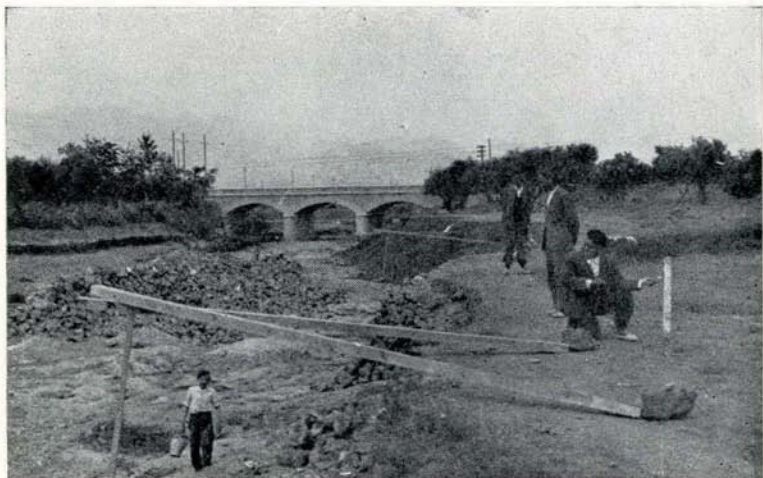
Detalle de los trabajos de encauzamiento del río, sobre el que se ha levantado el graderio voladizo
