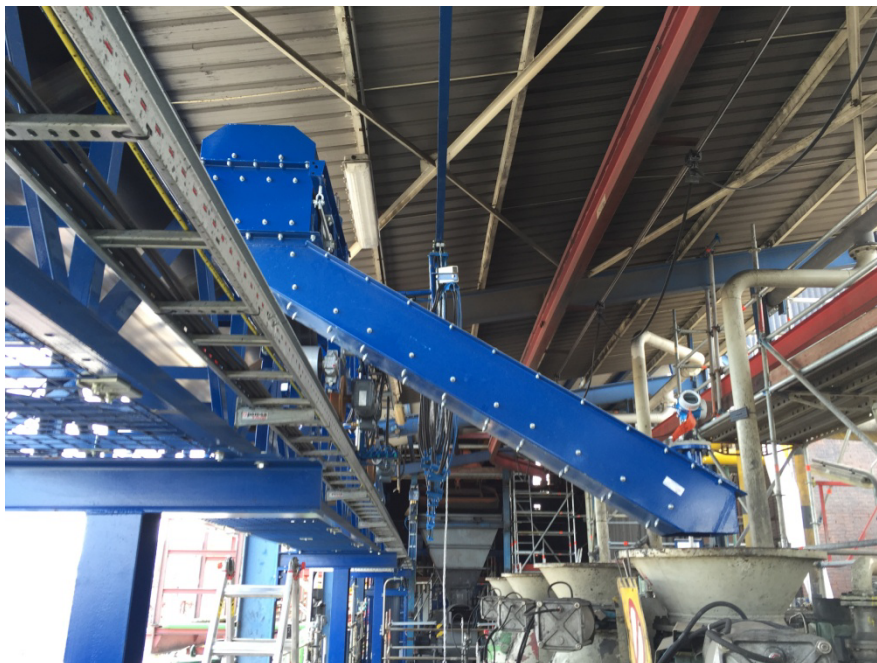
Ilustración 11. Descarga del Tripper al generador
