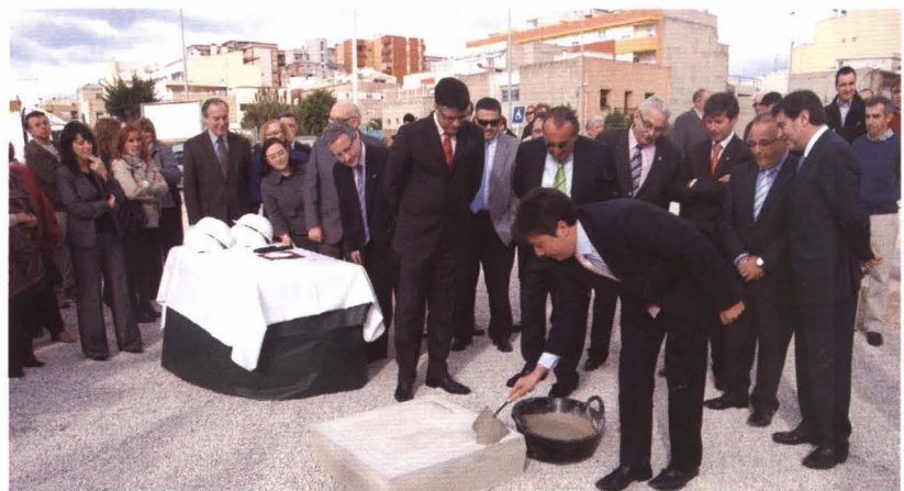
El conseller de Sanitat va posar la primera pedra del nou centre de salut de Benicarló
