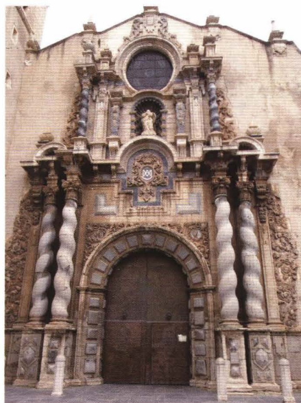
Arxiprestal. Fa més de 6 anys que ens vam quedar a mitja restauració
