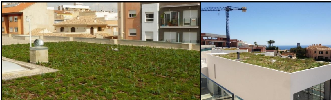
Figures 7.1 i 7.2 - ( www.paime.com ; www.singulargreen.com ): Coberta vegetal extensiva al centre de València i a una zona costera de Benidorm. Son cobertes que no requereixen cap manteniment regular més enllà dels elements constructius i reg en èpoques llargues de sequera.
