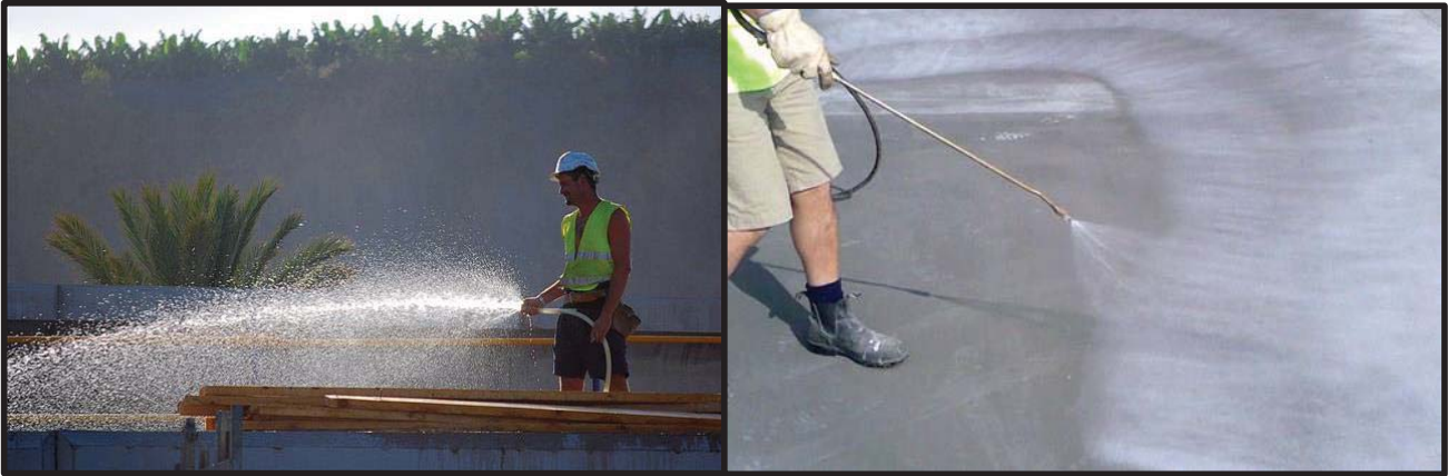
Figures 2 i 3: ( www.enriquealario.com , www.enriquealario.com ) És important haver curat correctament el forjat que sustentarà la coberta vegetal, així com que haja acabat de forjar el formigó i aquest tinga tota la seua resistència i capacitat portant.
