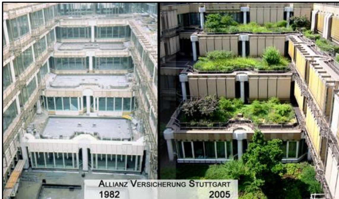
Figures 11.18 i 11.19: ( slideshare.net ) Edifici Allianz Versicherung a Stuttgart (Alemanya) durant la seva construcció al 1982 i després de la instal·lació d'una coberta vegetal. Va rebre el premi "Green Roof of the Year 2014" per l'associació més antiga de cobertes vegetals (DDV: Deutscher Dachgärtner Verband)
