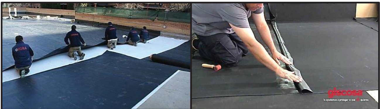
Figures 16 i 17: ( www.geora.es , yting.com ) Procés de col·locació de la lamina i unió de dues làmines amb imprimació.
