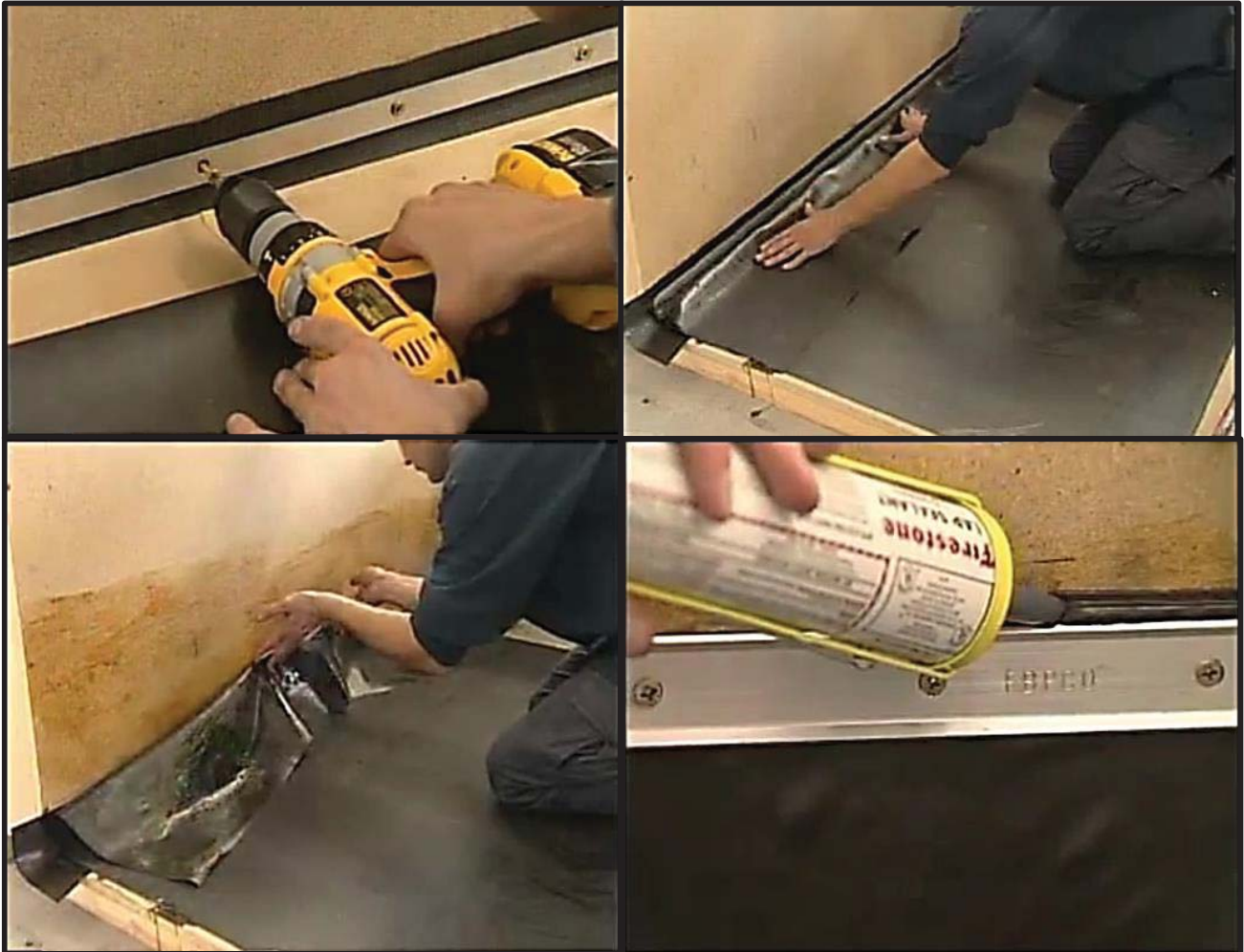
Figures 20 a 23: ( www.youtube.com ) Procés d'execució de l'encontre de la lamina d'EPDM amb el mur perimetral i remat amb perfil metàl·lic.
