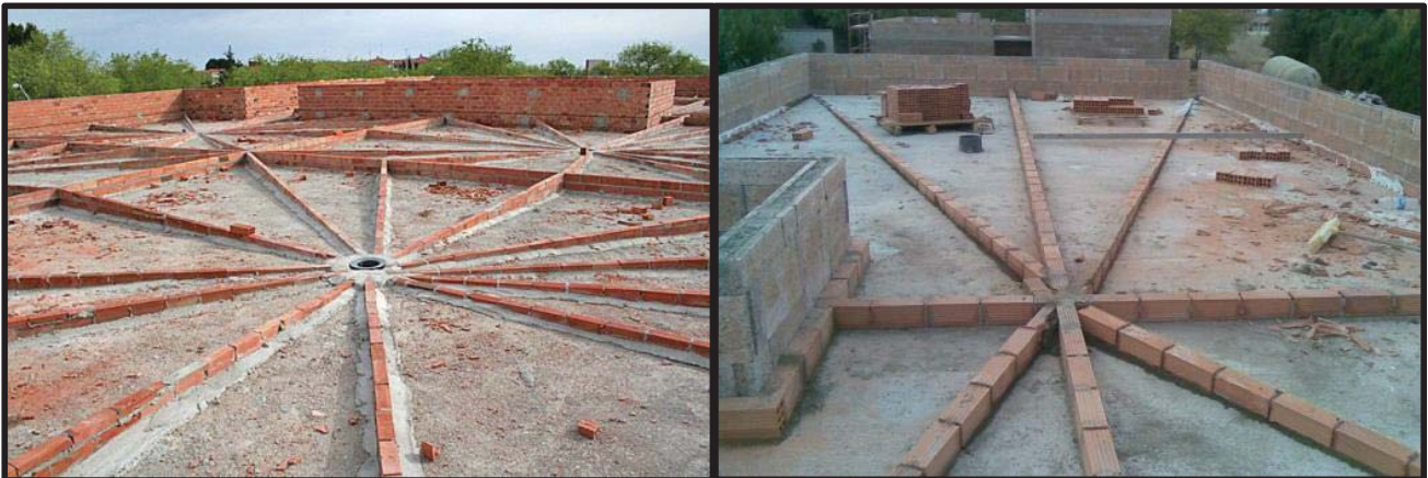
Figures 4 i 5: ( www.obrasonline.com , es.habcdn.com ) Realització de mestres de rajola on es pot veure el desguàs central i l'inici de la mestra superior en el cas de desguassos laterals.
