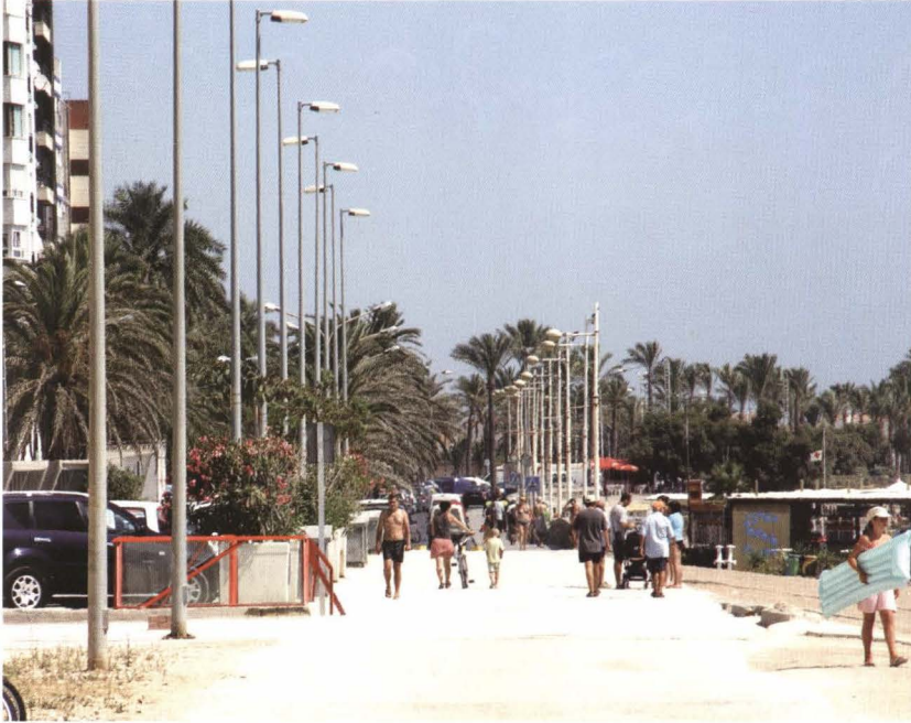
Les dos noves fases inclouen la finalització de la superfície de l'aparcament subterrani i el tram que transcorre entre el carrer de l'Àngel i el passeig de Fora del Forat
