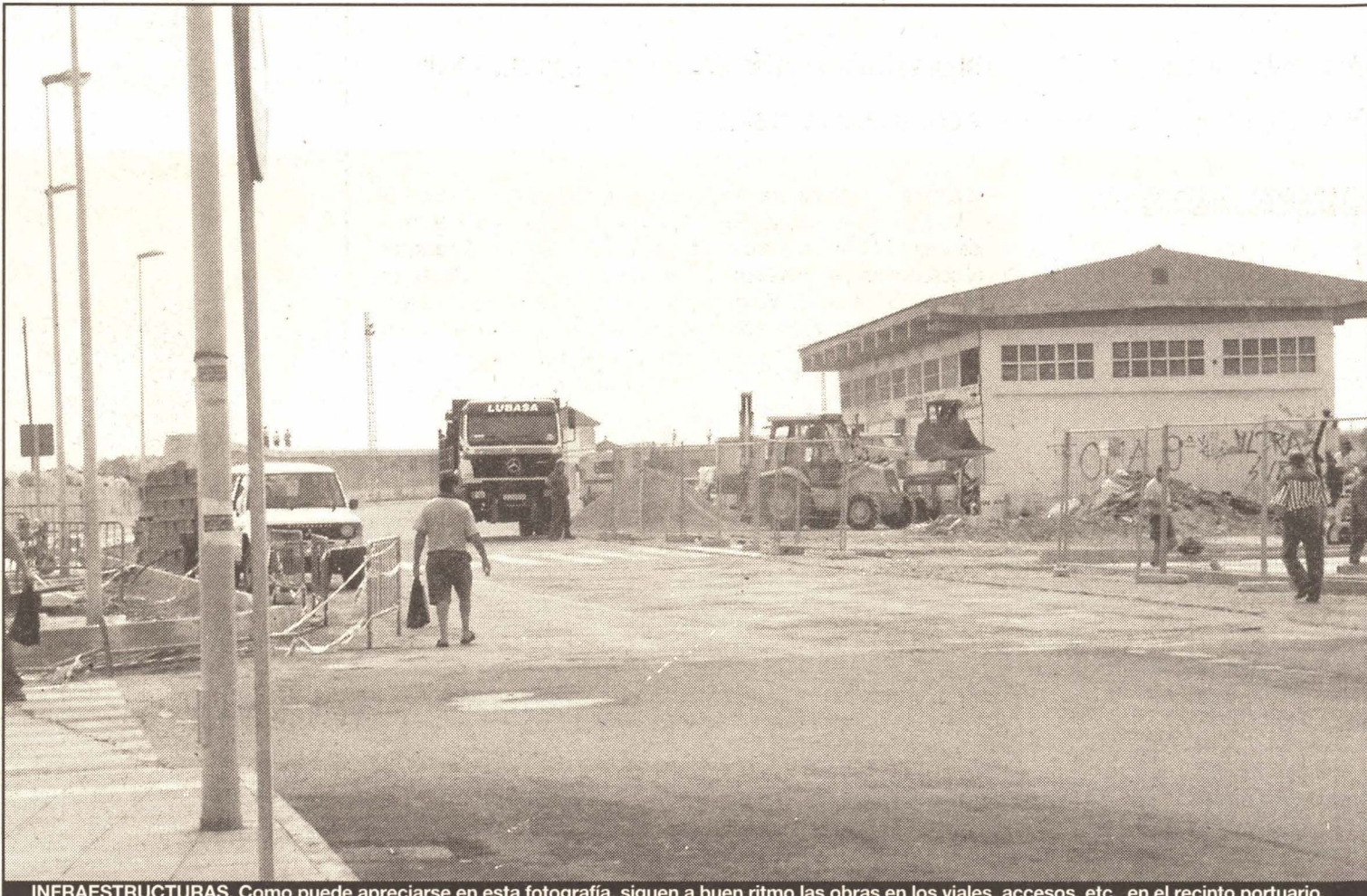
INFRAESTRUCTURAS. Como puede apreciarse en esta fotografía, siguen a buen ritmo las obras en los viales, accesos, etc., en el recinto portuario.
