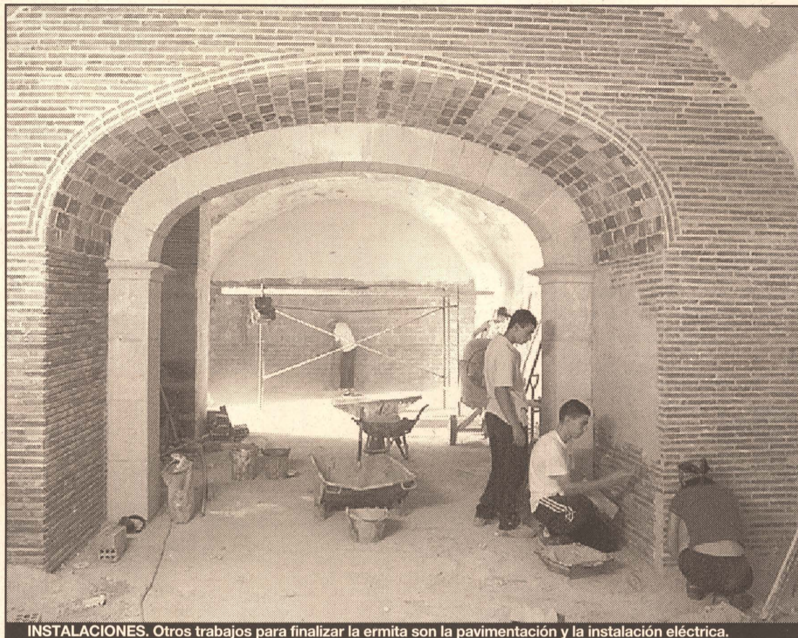
INSTALACIONES. Otros trabajos para finalizar la ermita son la pavimentación y la instalación eléctrica.
