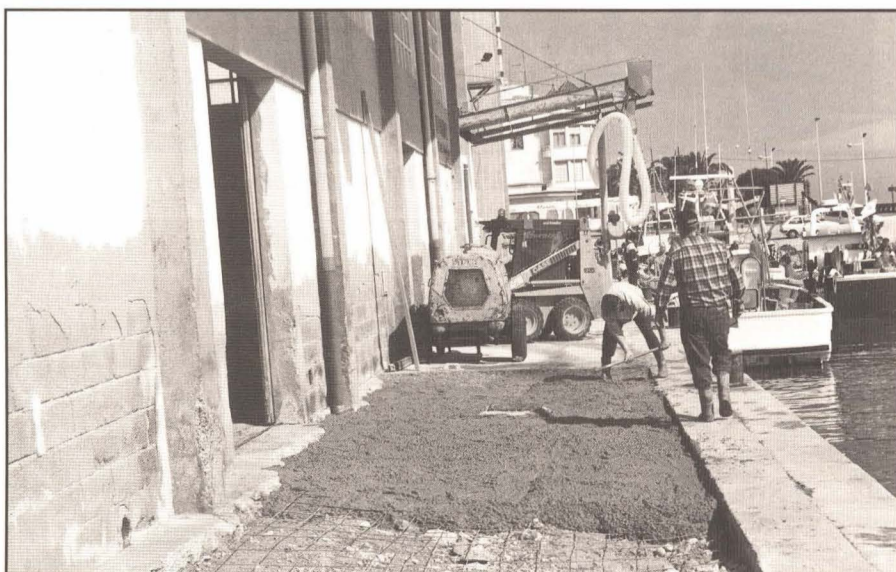
Obras portuarias para el atraque en lonja de los barcos. Foto: A. Alcázar
