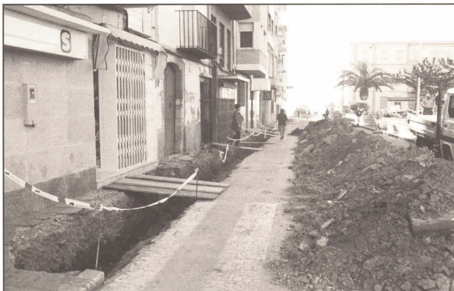
La plaza de San Antonio está en obras, se ampliarán las aceras existentes junto a los edificios. Por tanto, sólo se aparcará a una parte
