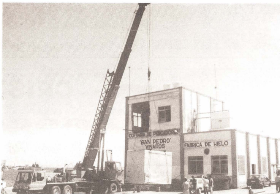
Instalación de un nuevo generador para producir más hielo en el puerto. Foto: A. Alcázar
