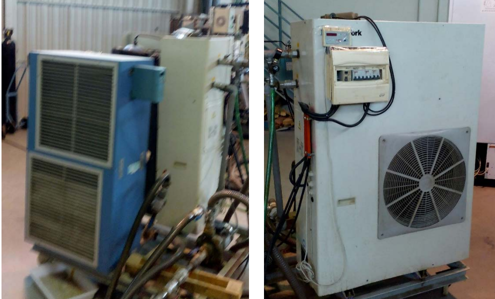
Figura 2-15 Unidad de simulación de carga en gas-cooler/condensador
