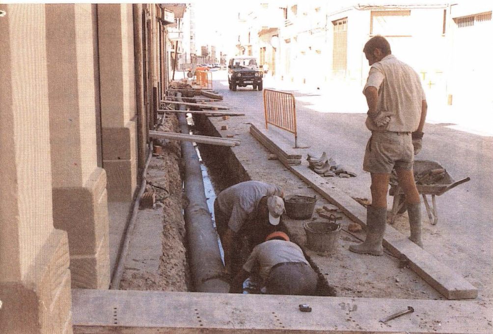
Obras de reconstrucción de las aceras de la calle del Pilar. Foto: Reula
