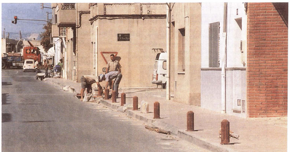
Las aceras de la calle del Pilar cuentan con protectores. Foto: Reula
