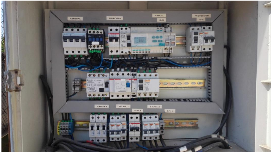
Ilustración 34. Elementos de protección y maniobra CM 33
