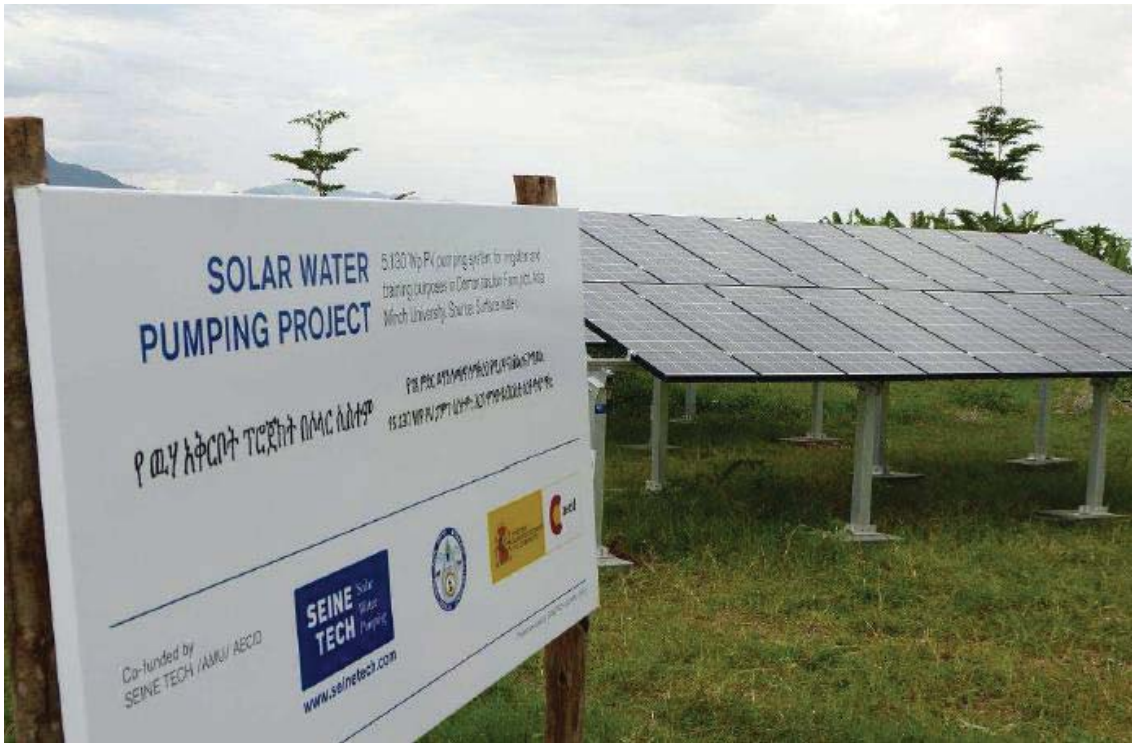
Vista de la mitad del generador fotovoltaico instalado junto al panel descriptivo del proyecto
