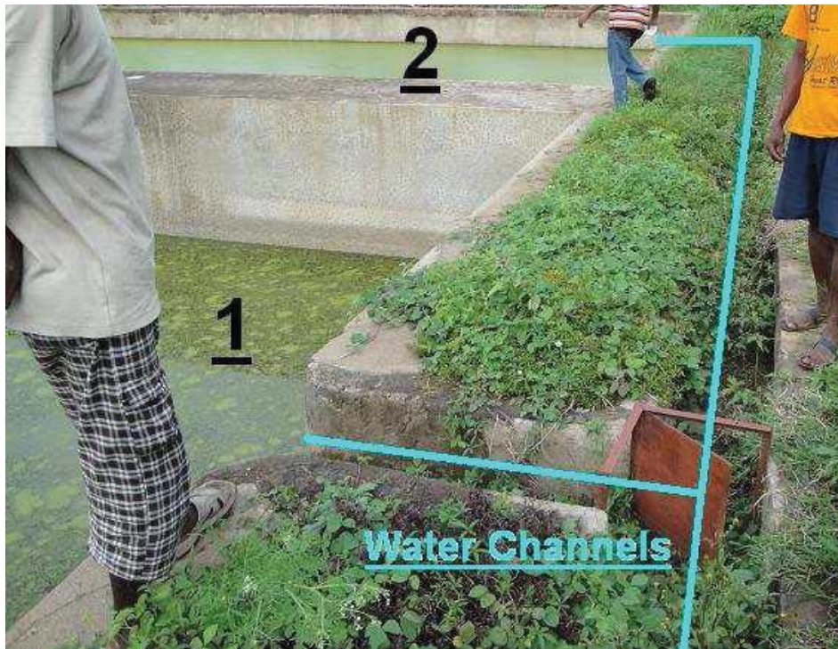
Balsas de almacenamiento desde balsa de sedimentación a través de canales.
